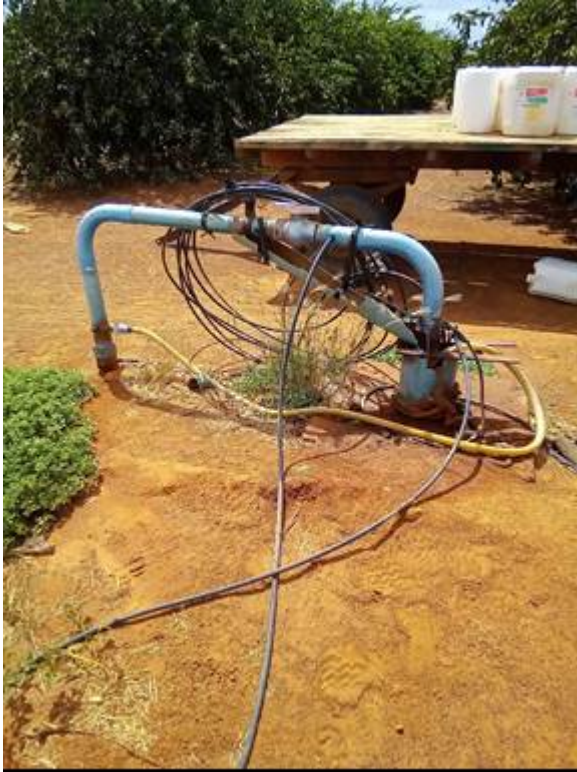
(a) Captação subterrânea.
